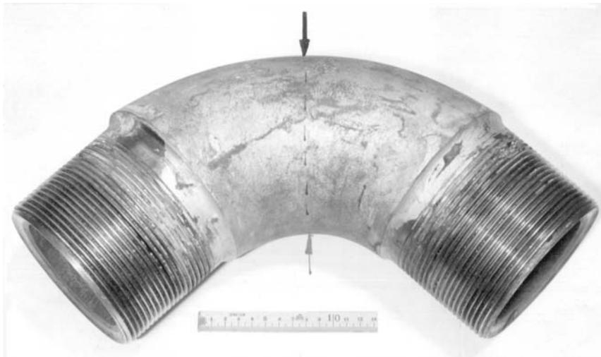
Bild 1 Rohrbogen, Risse im Scheitelpunkt
